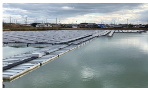
太陽電池フロート
