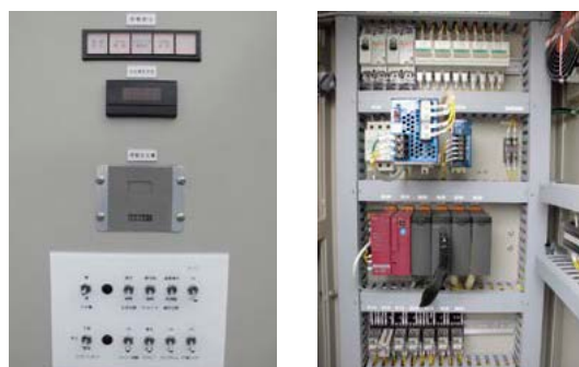
写真4 制御盤操作パネルと内部機器
